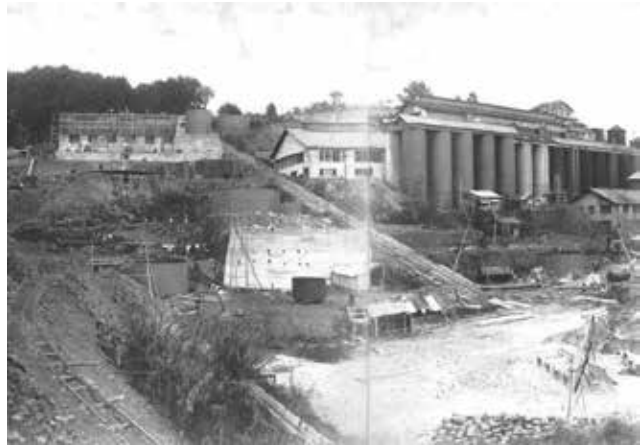
(写真 67) 青化製錬所第二工場(400t/日)の建設工事 (昭和 14 年(1939)1 月撮影)
