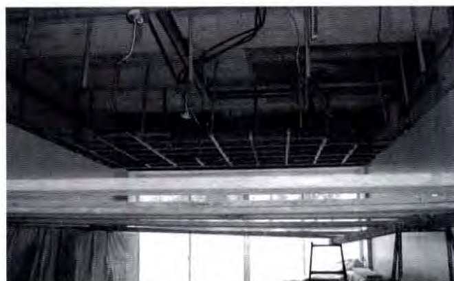
シロアリ被害で天井が落ちた理科準備室
