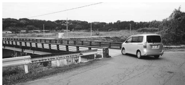
改良が望まれる海瀬橋
