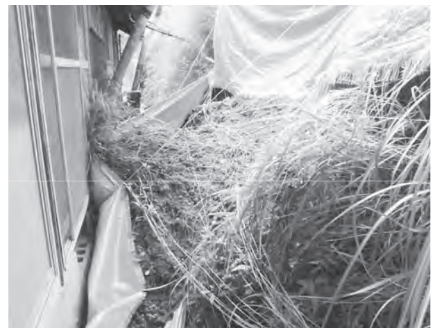
民家に土砂が迫る落シ平地区の状況
