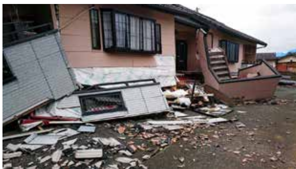
[倒壊したアパート]
