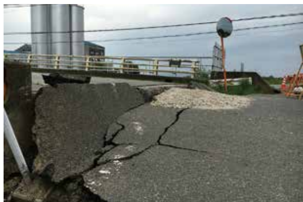
道路と橋の間にできた段差
