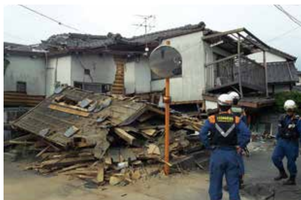
完全に倒壊した家屋
