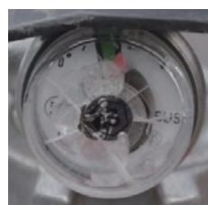
× 指示圧力計の損傷
