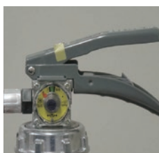
× 安全栓の脱落
