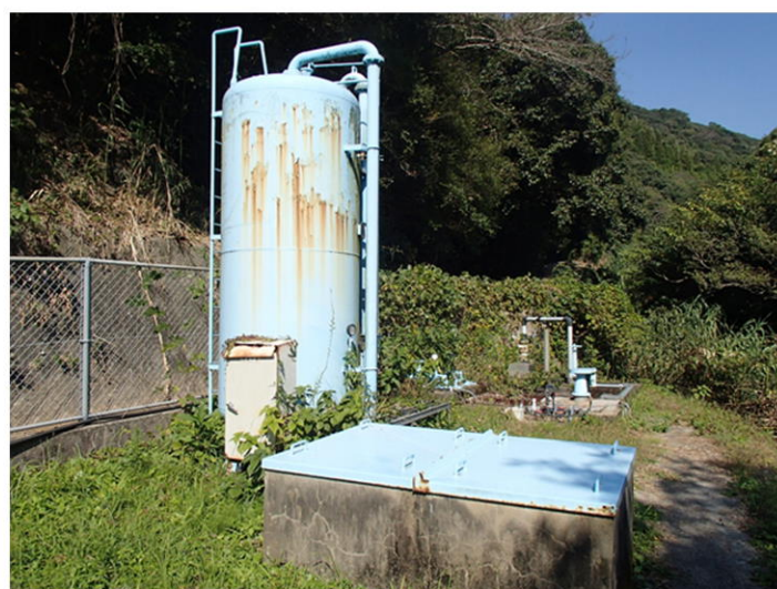
図 5-4-1 老朽化が進行する浄水施設（急速ろ過設備）
