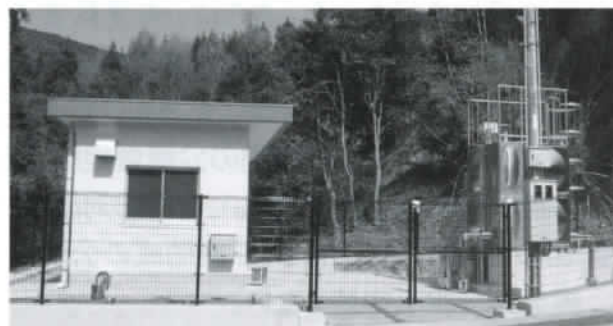
新設された深田地区ポンプ場
