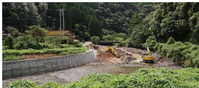
(八房川・中舟川橋付近の様子)
