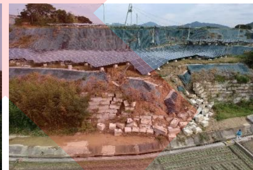
法面保護工が崩れて流出した事例
