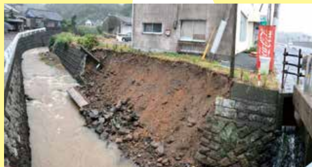
大雨によって崩れた護岸(羽島地区)
