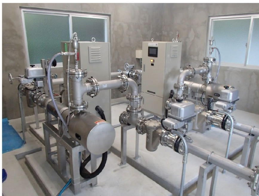
図 3-4-2-6 第 1 水源地(小ヶ倉) 紫外線処理設備
