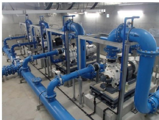
図 3-4-5-8 川上ポンプ場
