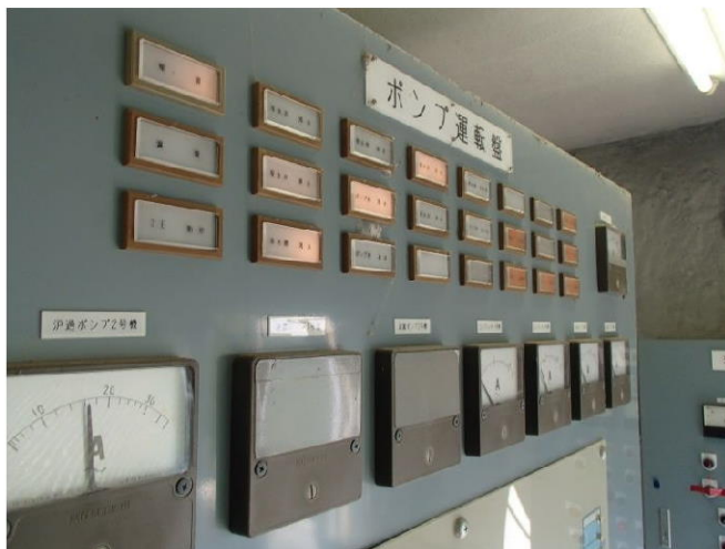
図 3-4-2-9 ポンプ運転盤
