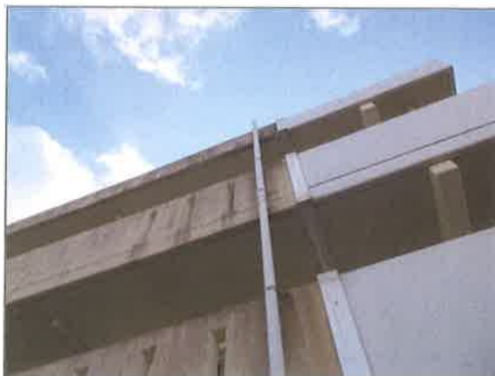
C棟 外壁状況・クラック
