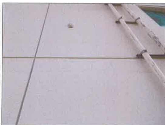
D棟 クラック
