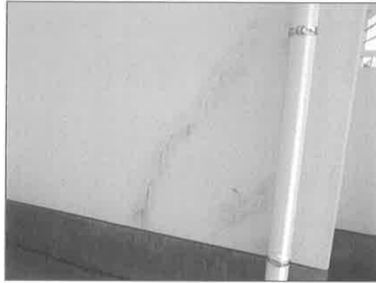
E棟 クラック
