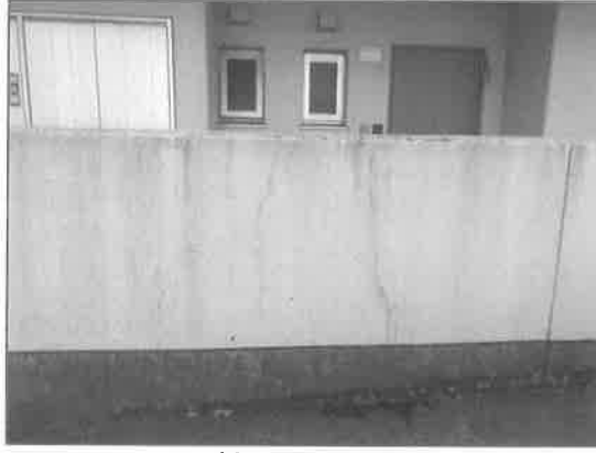
E棟 クラック
