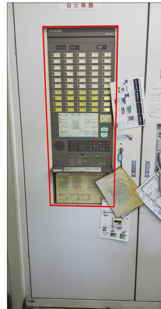
①防災監視盤 前面
