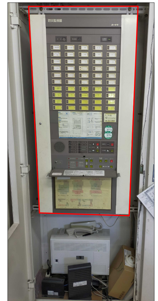
①防災監視盤 扉内
